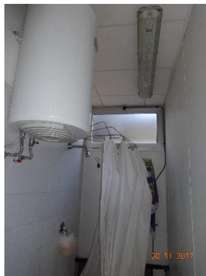
Figura 4.13 - Boiler ACS bagno personale e cucina
