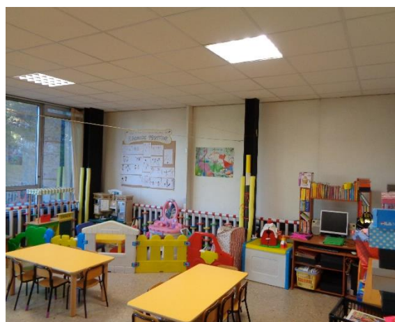
Figura 4.14 - Particolare corpi illuminanti aule
