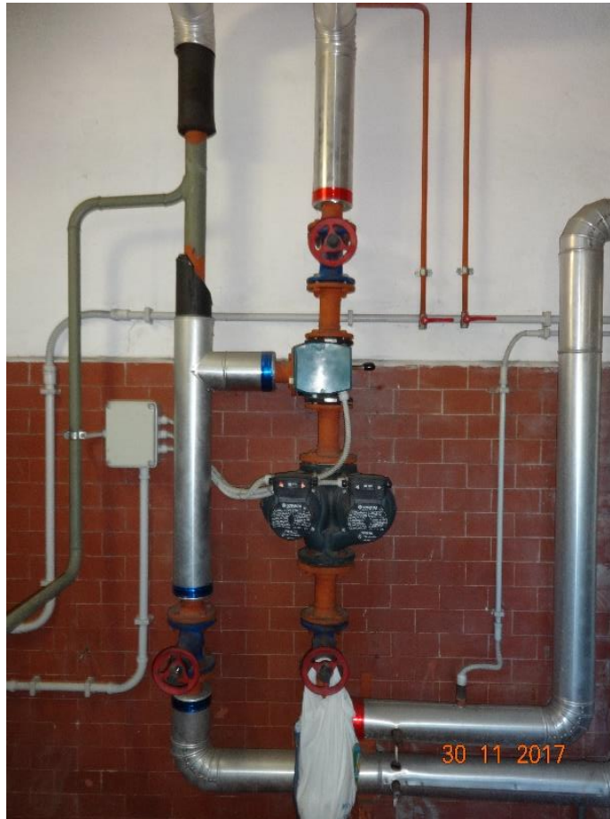
Figura 4.7 - Particolare della pompa di circolazione, valvola a 3 vie e lettura di temperatura
